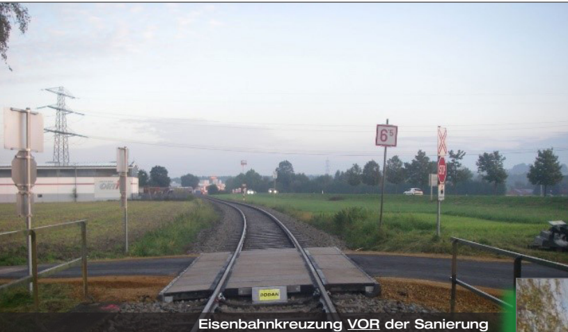
Eisenbahnkreuzung VOR der Sanierung
